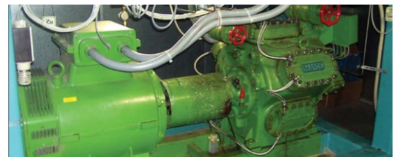
Kompressor der Wärmepumpe
